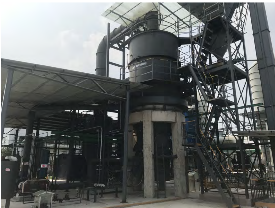
(循环流化床焚烧炉)
