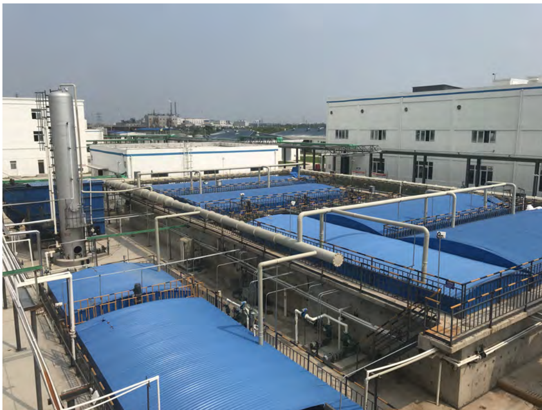
(污水处理系统)
