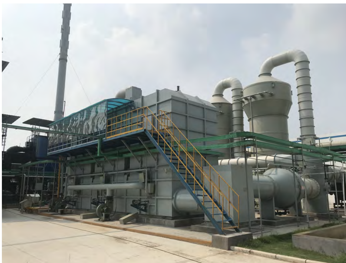
(蓄热式焚烧炉)
